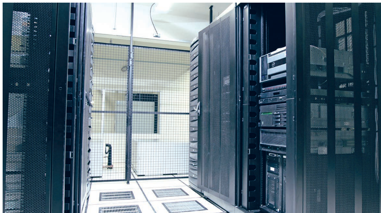
Data Center: segurança física e logística dos dados da Unifor.
