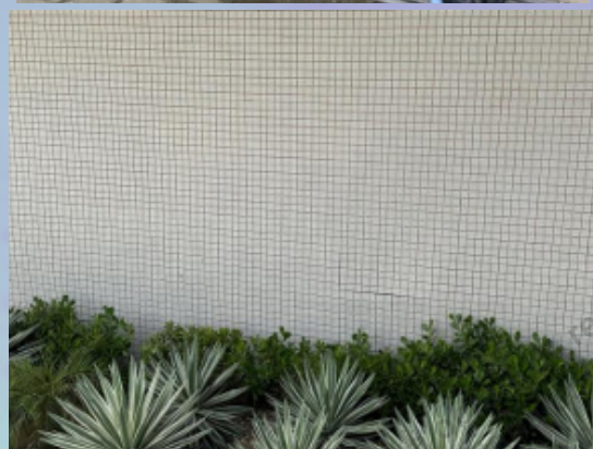
Figura 11 e 12 – Deslocamento de revestimento cerâmico em fachada e com som cavo
