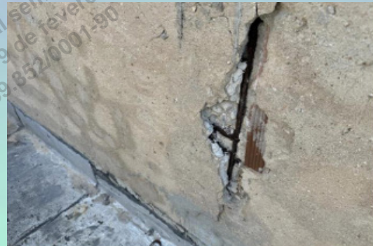
Figura 7 e 8 – Deslocamento na Caixa d'água
