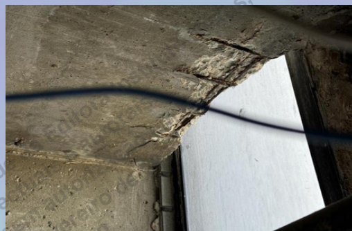
Figura 1 e 2 – Deslocamento de concreto na Torre A (Apartamento 1007)
