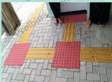
Figura 23 – Sinalização inadequada direcional sobre piso intertravado
